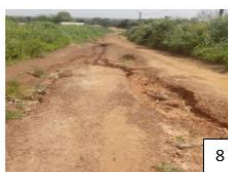
Photo 8 : Dégradation de la voie de Madjrè
