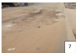
Photo 7 : Dégradation la voie bitumée
