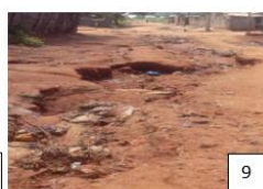
Photo 9 : Dégradation de la voie de Lokogohoué
