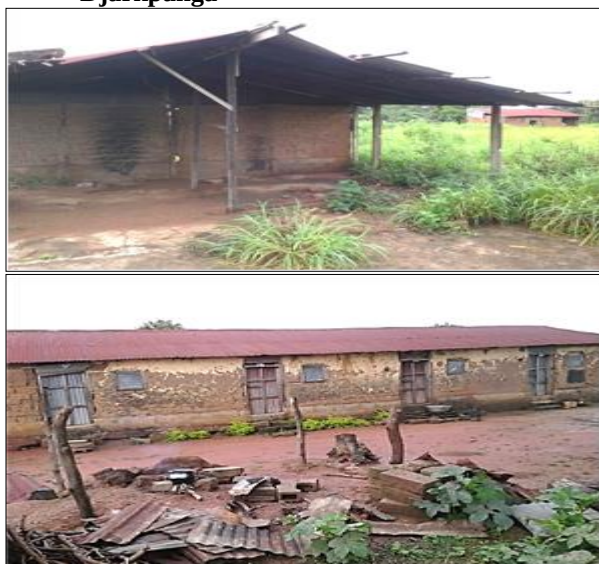
Planche n°1 : Ruines des bâtiments de l'ex camp de réfugiés ghanéens de Djarkpanga
