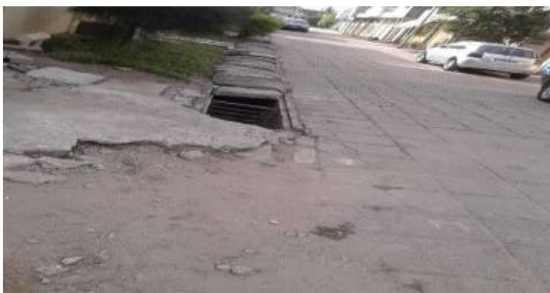
Photo 6 : une canalisation défailante à Angré- Caféier 5
